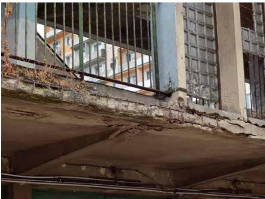
Rys. 5. Uszkodzenia otuliny w rejonie stropu; źródło: zdj. autora
