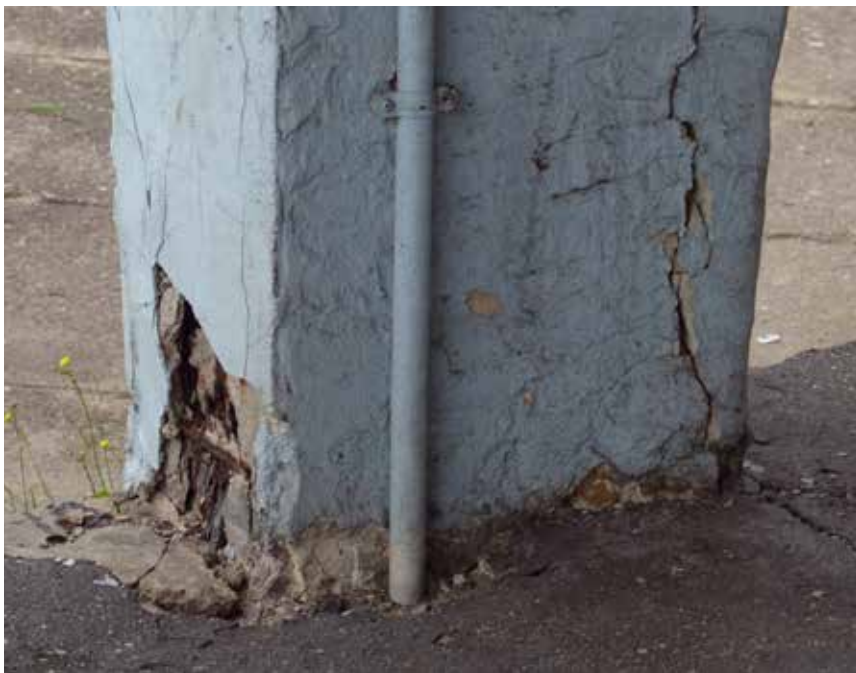
Rys. 4. Uszkodzenia u podstawy jednego ze słupów; źródło: zdj. autora
