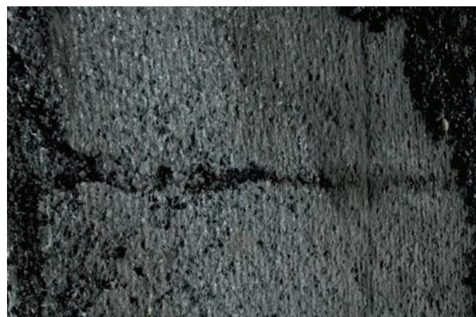
Fot. 14. Spękanie w warstwie wiążącej propagujące w głąb konstrukcji nawierzchni
