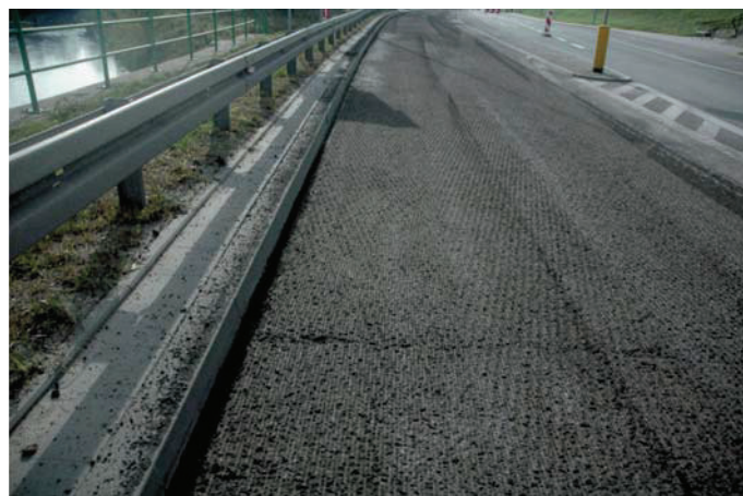
Fot. 13. Spękanie w warstwie wiążącej propagujące w głąb konstrukcji nawierzchni
