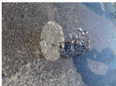
Fot. 7. Próbkę odwierconą w obszarze spękania podłużnego (widoczne spękanie przez warstwy ścieralna i wiążąca) [7]
