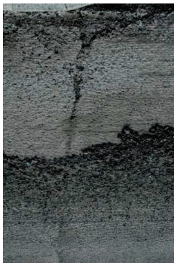
Fot. 19. Spękanie propagujące w głąb konstrukcji nawierzchni
