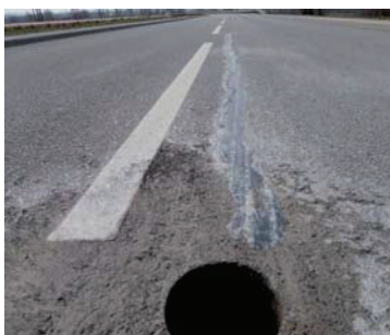
Fot. 3. Spękanie podłużne [7]
