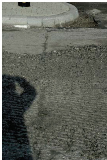
Fot. 18. Spękanie propagujące w głąb konstrukcji nawierzchni
