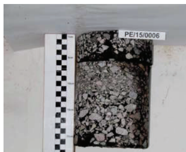
Fot. 5. Próbkę odwierconą w obszarze spękania poprzecznego (widoczne spękanie tylko warstwy ścieralnej) [7]
