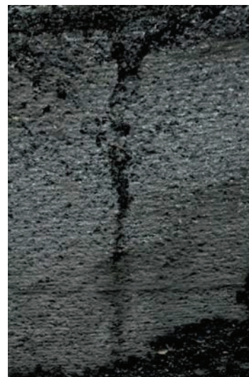
Fot. 20. Spękanie propagujące w głąb konstrukcji nawierzchni
