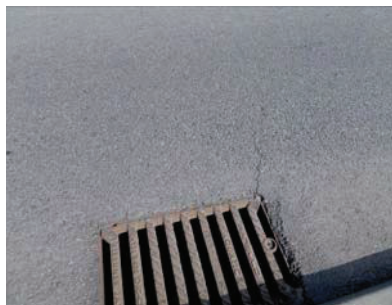
Fot. 2. Spękanie przy studziencie [7]
