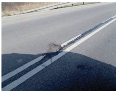
Fot. 4. Ubytek w warstwie ścieralnej [7]
