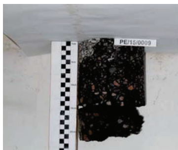
Fot. 8. Próbkę odwierconą w obszarze spękania przy studziencie (widoczne spękanie przez wszystkie warstwy asfaltowe) [7]
