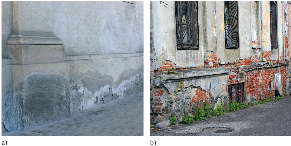
Rys. 1. Przykładowy widok: a) postępującego procesu zawilgocenia i zasolenia; b) zniszczeń muru spowodowanych długotrwałym nadmiernym zawilgoceniem i zasoleniem
