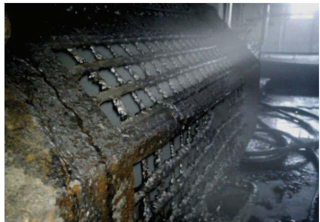
Rys. 9. Efekt osadzania się zwilżonego pyłu na kratce rewizyjnej [7]
