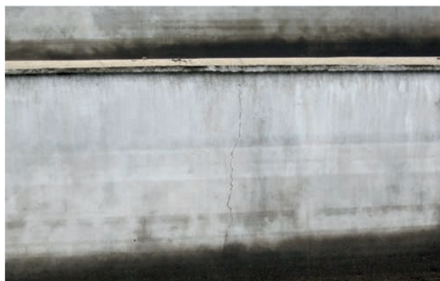
Rysunek 2 Widok zarysowanej ściany zbiornika Figure 2 View scratch the walls of the tank
