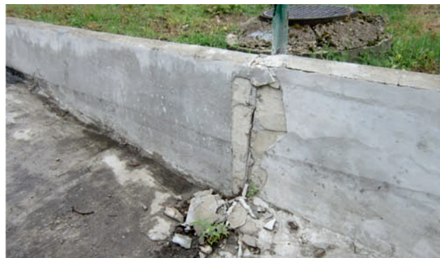
Rysunek 11 Widok odspojenia się tynku wraz z warstwą betonu ściany wjazdu do zbiornika oraz prac wykonanych przy przerwie dylatacyjnej
