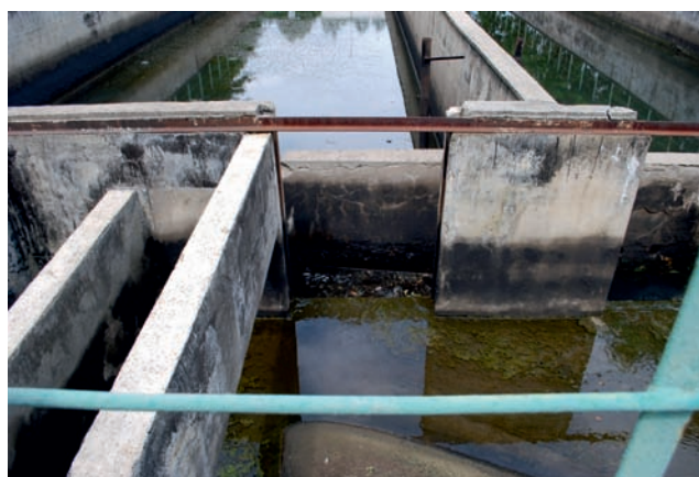
Rysunek 4 Widok części zbiornika z występującymi uszkodzeniami Figure 4 View of the tank with damage
