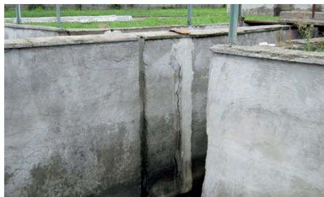
Rysunek 12 Widok prac wykonanych przy przerwie dylatacyjnej oraz pionowe pęknięcie powstałe po przeprowadzonych pracach
