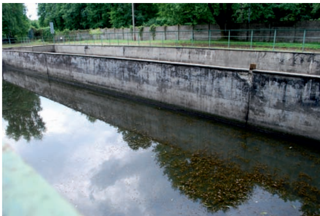
Rysunek 5 Widok przerwy dylatacyjnej zbiornika z występującymi uszkodzeniami
