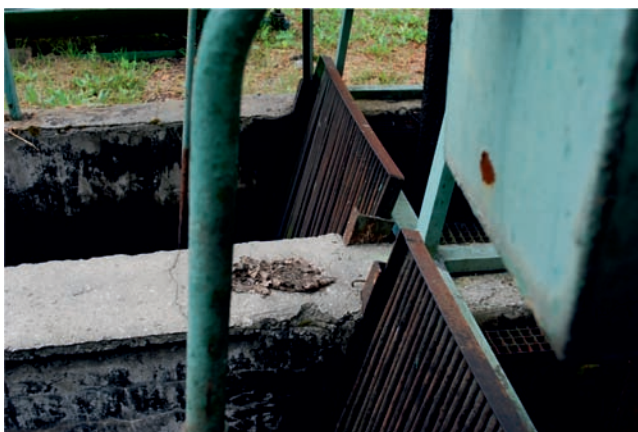
Rysunek 6 Widok części zbiornika z występującymi uszkodzeniami
