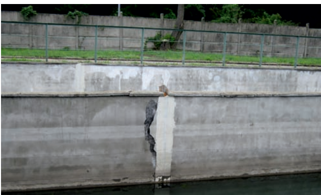
Rysunek 10 Widok odspojenia się warstwy betonu ściany wewnętrznej zbiornika oraz prac wykonanych przy przerwie dylatacyjnej
