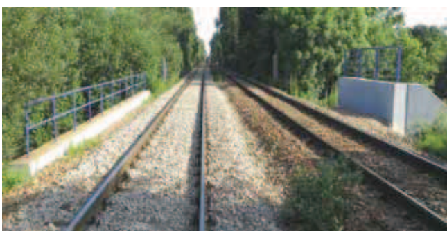
Rys. 14. Widok na tor na wiadukcie po przebudowie [9] Fig. 14. View on railway track no. 1 after rebuilding [9]
