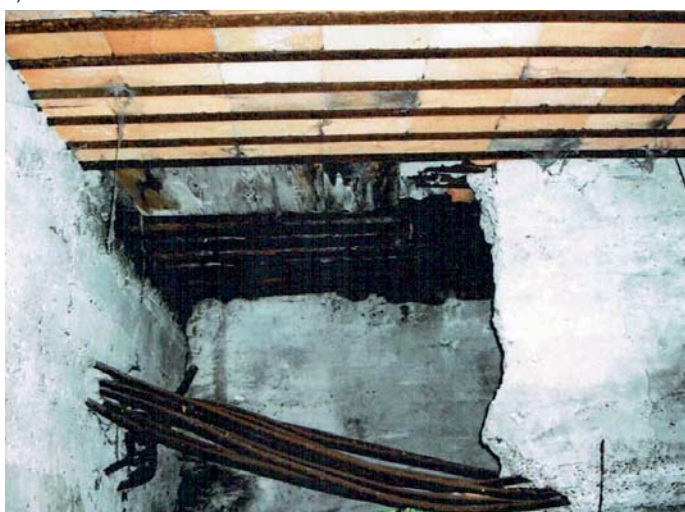
Fot. 5. Suchy Most na Zalewie rzeki Bug w Terespolu: a) widok z boku, b) filar z izbicą, c) uszkodzenia dźwigarów głównych – stan w 2003 r. [8]
