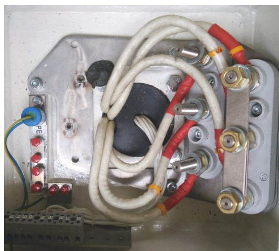
Rys. 5. Widok silnika 2SP1 280M-6A oraz widok wnętrza jego skrzynki zaciskowej
