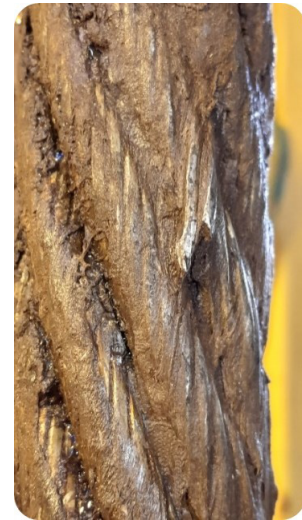
Rys. 3.4. Pęknięte druty. Fig. 3.4. Broken wires
