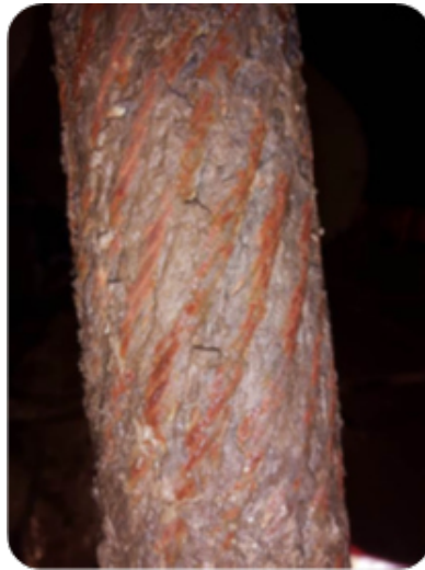
Rys. 3.3. Korozja zewnętrzna. Fig. 3.3. External corrosion
