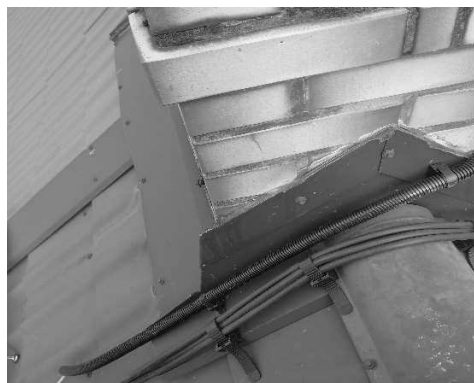
Rys. 4. Przykład a) nieprawidłowego, bez mocowania prowadzenia przewodów na dachu budynku, b) rozwiązanie prawidłowe
