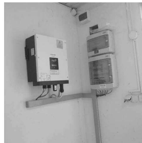
Rys. 6. Przykład a) nieprawidłowego łączenia przewodów od falownika do RG w pomieszczeniu garażu, brak uszczelnienia miejsca przejścia przewodów pomiędzy pomieszczeniami, b) rozwiązanie prawidłowe
