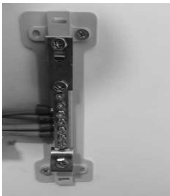
Rys. 8. Połączenia przewodów ochronnych i neutralnych, a) wadliwe (brak uporządkowania przewodów), b) prawidłowe wykonanie połączeń przewodów ochronnych w rozdzielnicach
