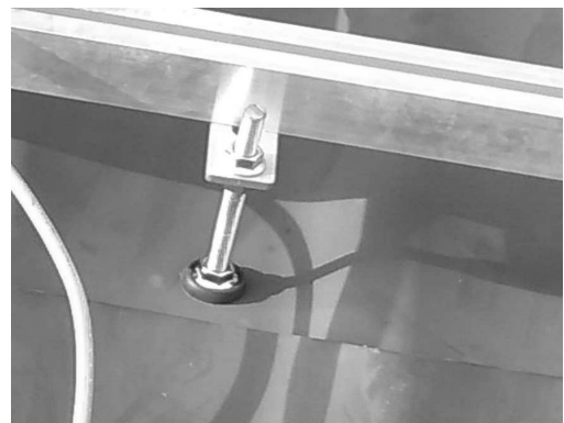
Rys. 5. a) Nieprawidłowy montaż bezpośrednio do konstrukcji powodujący naprężenia, b) rozwiązanie prawidłowe
