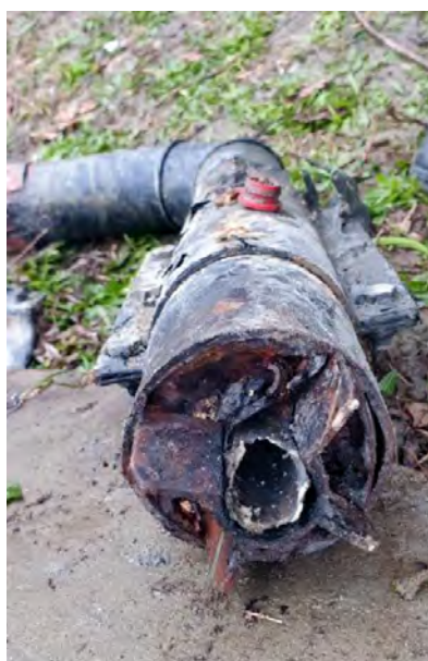
Awaria - nieszczelna mufa składana na odpowietrzeniu, wyciek w granicach kilkuset litrów na godzinę
