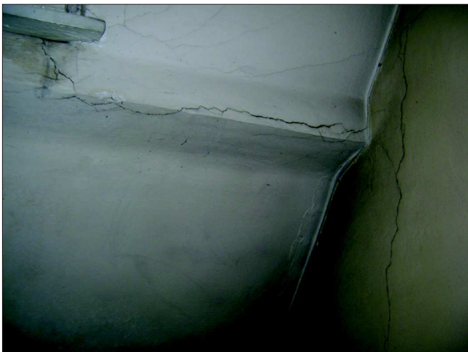
Fot. 4. Rysa w tynku na ścianie zachodniej (autor: A. Kowalska-Koczwarą)
