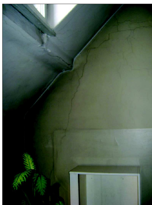
Fot. 3. Widok ogólny zarysowań na ścianie zachodniej (autor: A. Kowalska-Koczwarą)
