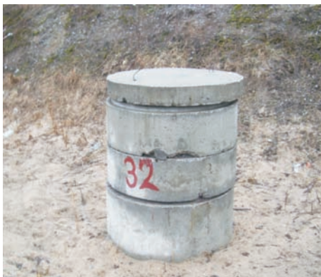
Fot. 1. Studzienka z odciekami
