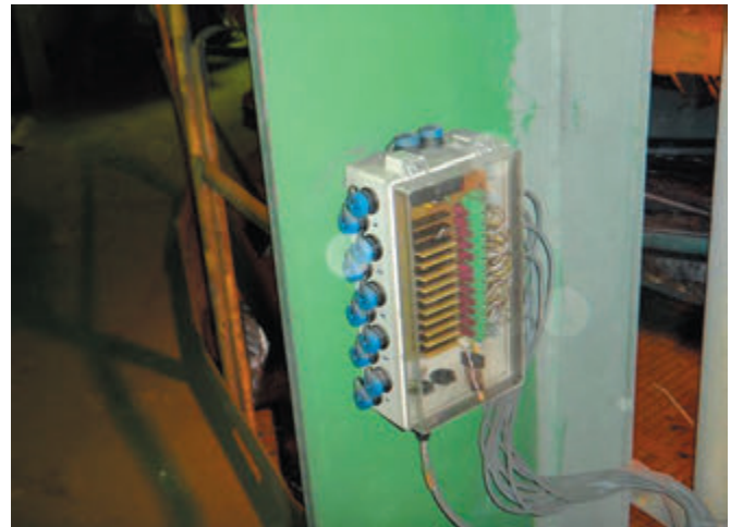
Rys. 3. Prototypowy układ przetworników A/C w przesypie centralnym kopalni
