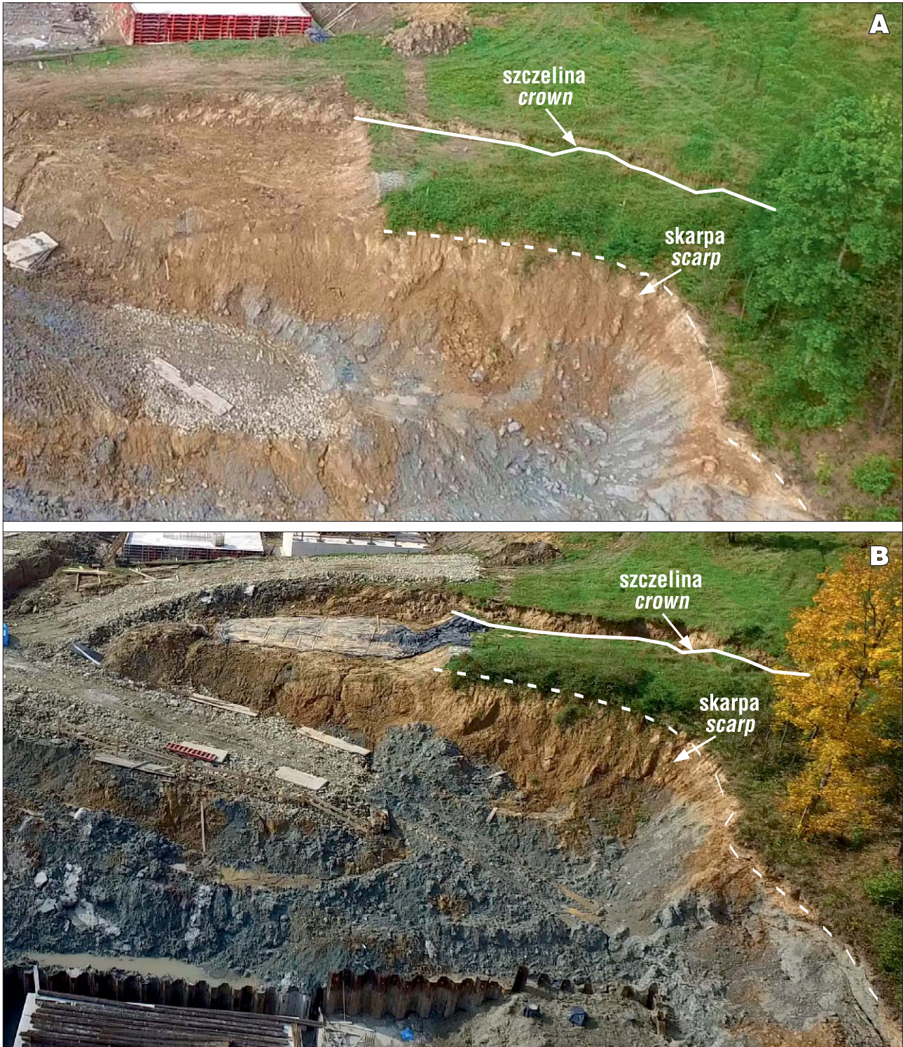
Ryc. 4. Aktywna część osuwiska w rejonie budowanej drogi ekspresowej S-7 w Lubnie: A – 26.08.2017 r.; B – 30.09.2017 r. Fot. S. Jurczak
