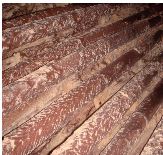
Rys. 6. Korozja wysokotemperaturowa na elementach ciśnieniowych kotła
