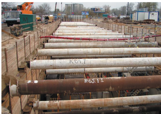
Fot. 3. Berlińska obudowa wykopu stacji „Stodowiec” na I linii metra w Warszawie Źródło: [3]
