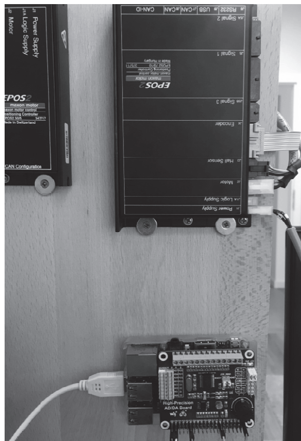
Rys. 9. Fragment stanowiska testowego zawierający sterownik silnika BLDC MAXON EPOS 70/10 oraz modułu Raspberry Pi
