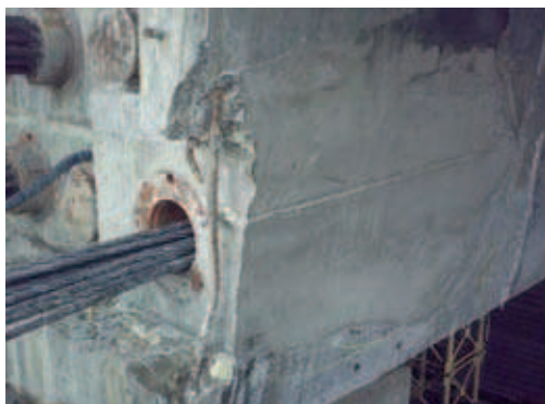
Rys. 7. Uszkodzona strefa zakotwień przed i po wprowadzeniu programu naprawczego
