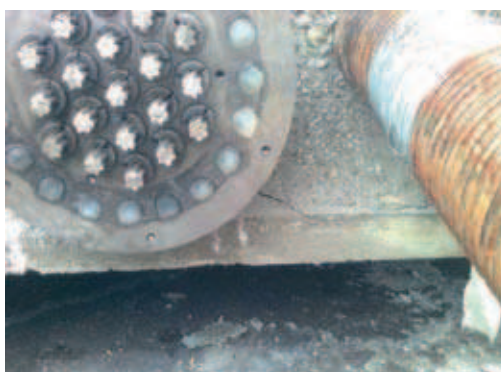
Rys. 8. Ukośne pęknięcie powstałe podczas sprężania przy głowicy cięgna
