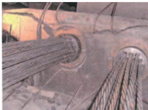
Rys. 5. Uszkodzenie strefy zakotwień spowodowane niewystarczającą ilością zbrojenia
