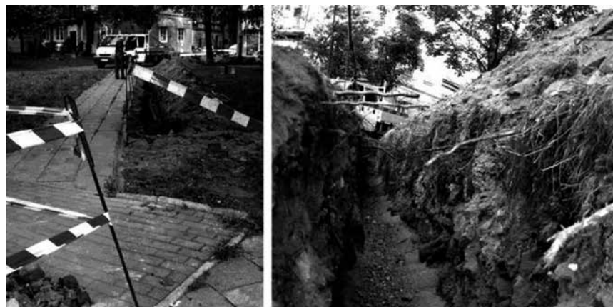
Rys. 4. Wykopy trasy elektrycznej z 2007 r. w okolicy dawnej apsydy oraz inne trasy infrastruktury podziemnej z lat poprzednich oraz próba ustalenia lokalizacji kościoła Św. Jerzego wg J. Zielińskiego oraz pomiarów S. Żaryna; źródło: opracowanie, foto – autor
