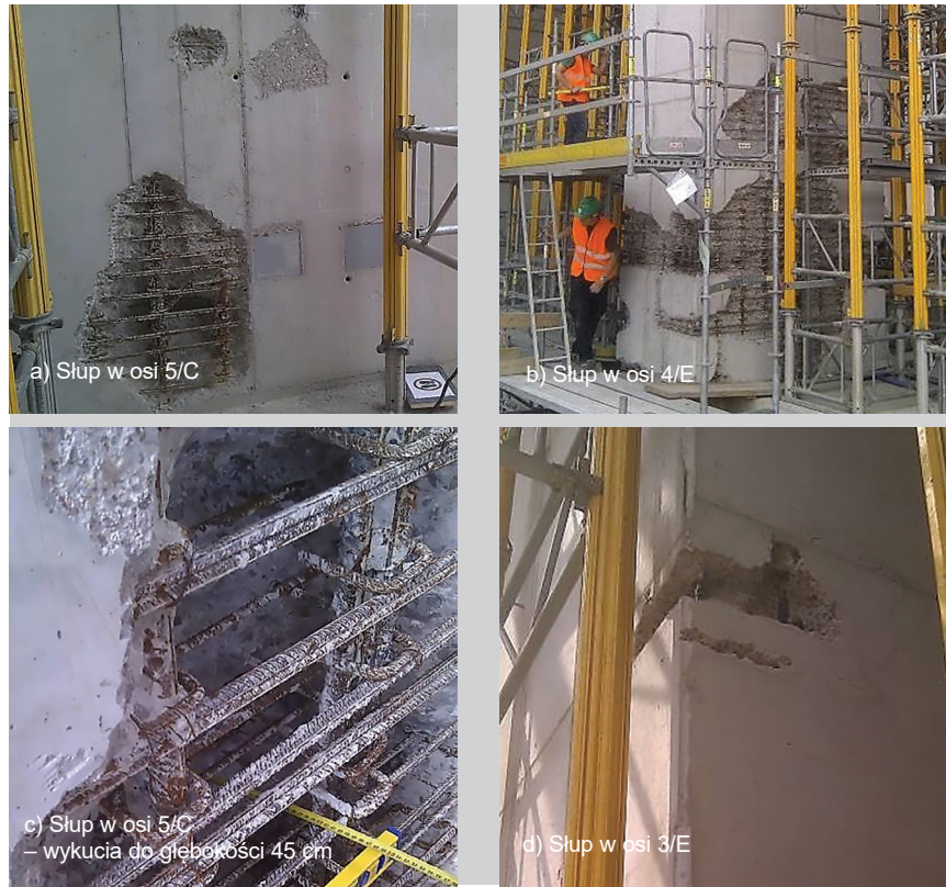
Rys. 3. Przykłady uszkodzeń słupów fundamentu turbozespołu
