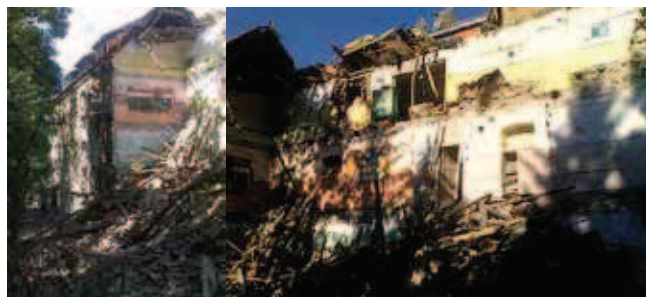
Rys. 1. Stan budynku zespołu szkół bezpośrednio po katastrofie budowlanej
