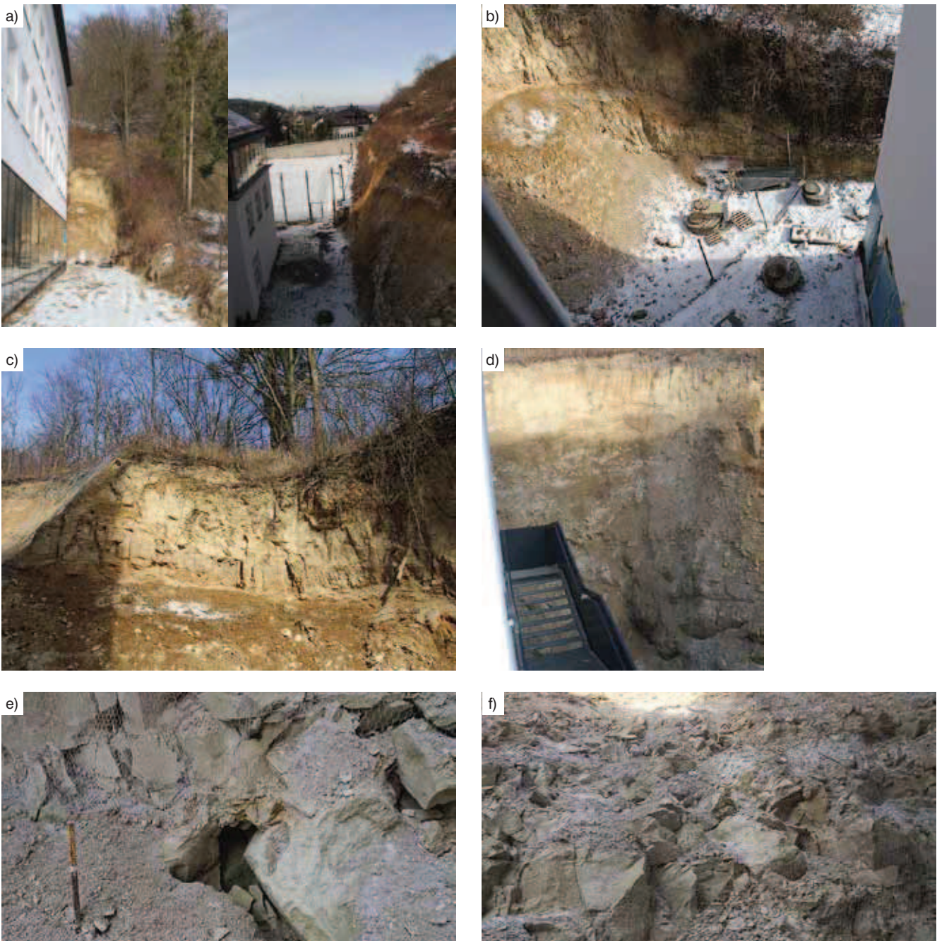
Rys. 9. Widok podciętej skarpy i widoczny brak jej zabezpieczenia (a), aktualny stan skarpy (b-f)
