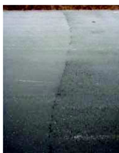
Fot. 10. Niejednorodność powierzchni podbudowy asfaltowej, spękanie na granicy zmiany struktury
