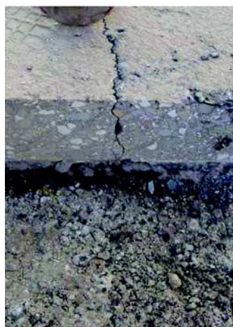
Fot. 11. Propagacja spękania przez podbudowę AC WMS widoczna w warstwie kruszywa łamanego
