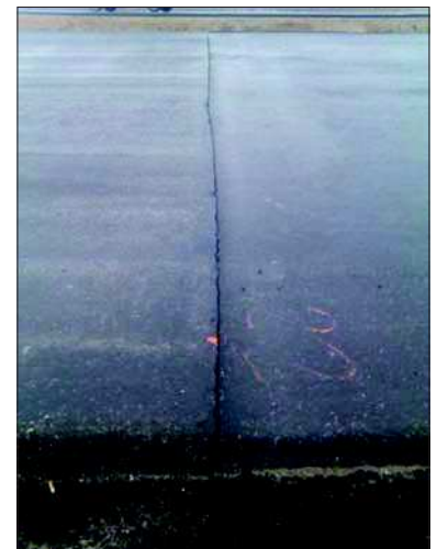
Fot. 2. Spękanie poprzeczne zlokalizowane w spoinie technologicznej ( JLTC )
