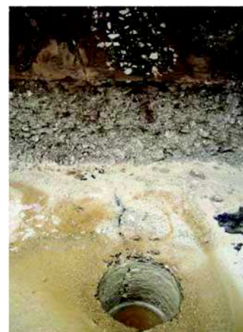
Fot. 12. Propagacja spękania przez podbudowę AC WMS oraz przez warstwę kruszywa łamanego jest widoczna w warstwie związanej cementem
