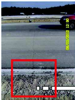
Rys.1. Spękanie LTC, przebieg poniżej podbudowy asfaltowej
