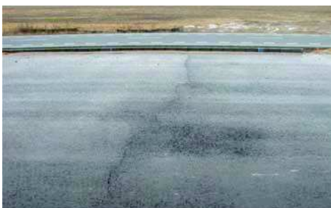
Fot. 7. Niejednorodność powierzchni podbudowy asfaltowej
