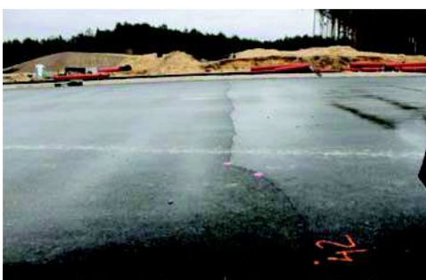
Fot. 9. Niejednorodność powierzchni podbudowy asfaltowej, spękanie na granicy zmiany struktury
