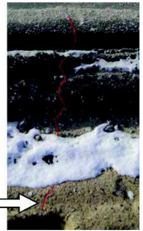
Rys. 4. Spękanie LTC, powiększenie rys. 3, czerwona linia odwzorowuje przebieg spękania
