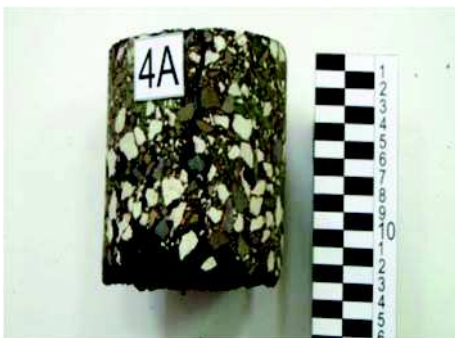
Fot. 16. Spękanie propaguje częściowo i zanika w warstwie dolnej
