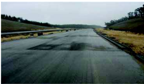
Fot. 5. Niejednorodność powierzchni podbudowy asfaltowej
