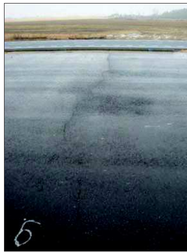
Fot. 1. Spękanie poprzeczne zlokalizowane poza spoiną technologiczną ( LTC )
