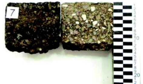
Fot. 18. Brak uszczelnienia połączenia technologicznego
