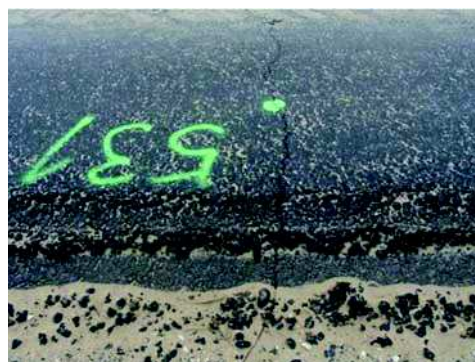
Fot. 3. Spękanie poprzeczne poza spoiną technologiczną, przebieg przez dwuwarstwową podbudowę asfaltową
