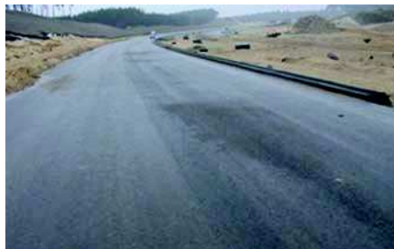
Fot. 6. Niejednorodność powierzchni podbudowy asfaltowej
