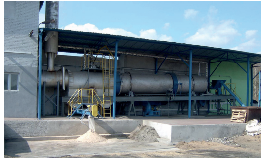
Rys. 2. Ogólny widok instalacji o mocy 12MW.
