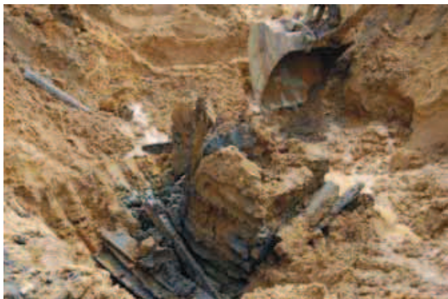
Rys. 1. Zasypany rodzimym gruntem szyb w obszarze występowania złóż cynku i ołowiu w Bytomiu-Dąbrowie
