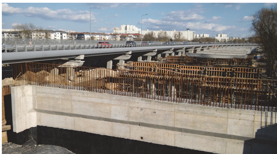
Rys. 1. Widok na Estakadę Katowicką w przebudowie. Obiekt północny oddany do użytku, obiekt południowy w trakcie budowy
