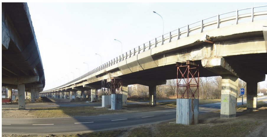
Rys. 5. Zły stan techniczny Estakady Katowickiej przed przebudową (2015 r.) [4]
