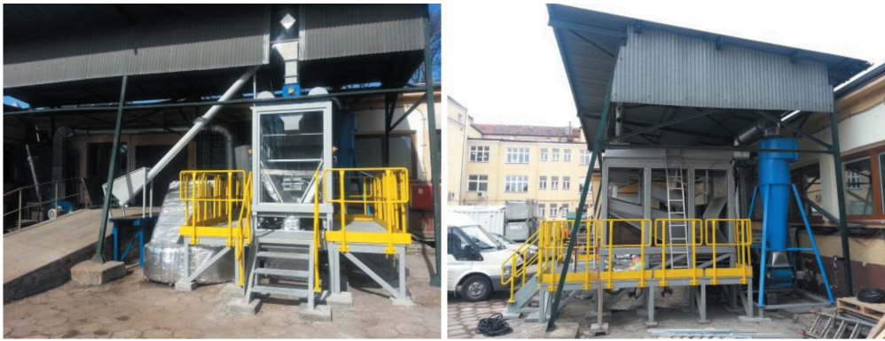
Rys. 7. Ukończona instalacja pilotowa do wstępnego suszenia węgla brunatnego Fig. 7. Completed pilot plant for pre-drying brown coal
