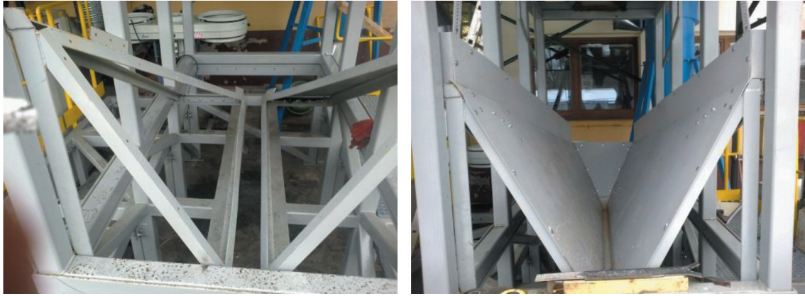
Rys. 4. Fazy montażu konstrukcji komory fluidalnej Fig. 4. Installation phases of the turbulence chamber
