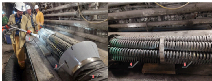
Rys.7. Stanowisko czyszczenia: 1 – dysza, 2 – ssawa, 3 – przewód ssący, 4 – brudna część wymiennika, 5 – czysta część wymiennika Fig. 7. Cleaning station: 1 – nozzle, 2 – suction nozzle, 3 – suction pipe, 4 – dirty part of the exchanger, 5 – clean part of the exchanger
