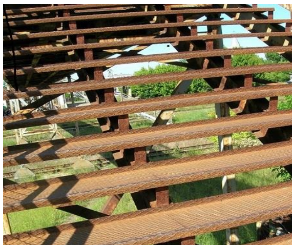
Rys. 1. Fragment skorodowanych schodów kładki nad torami kolejowymi; widok z góry (fot. własna)
