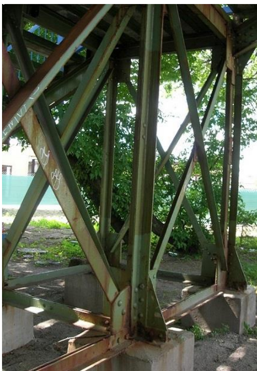
Rys. 3. Fragment skorodowanej konstrukcji kładki; (fot. własna)
