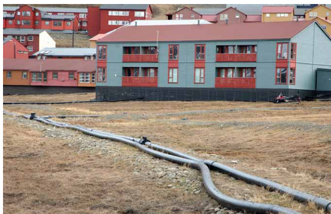
Przyłącza kablowe w rurach ochronnych do domów wybudowanych w strefie wiecznej zmarzliny
