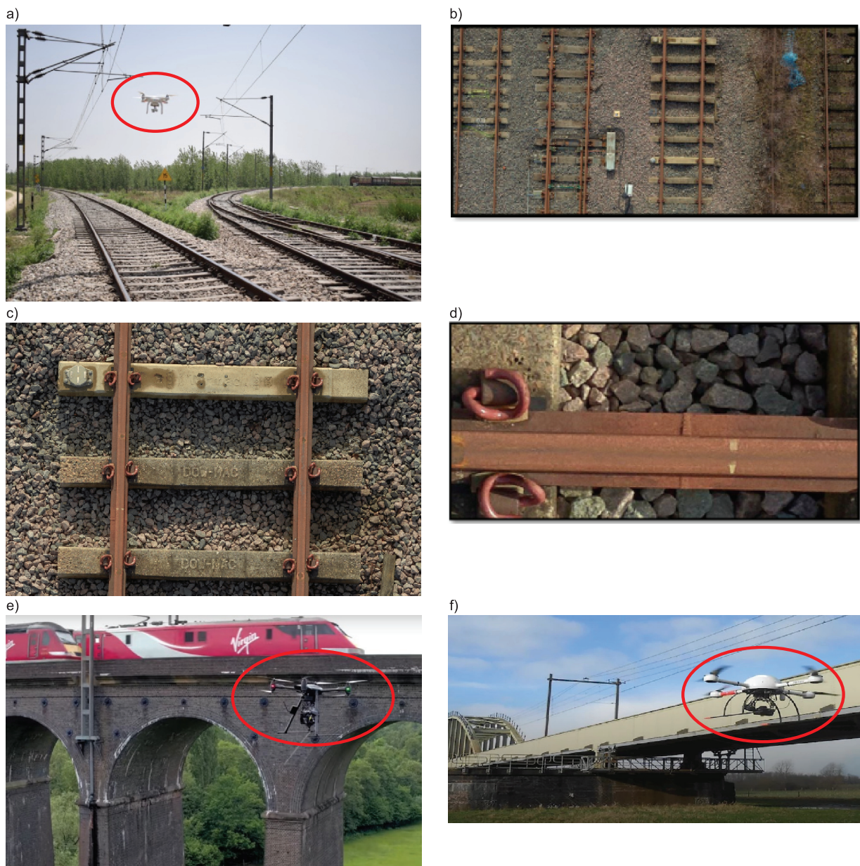
Rys. 2. Inspekcja infrastruktury kolejowej dronem: a) badanie toru [12], b) widok ogólny toru z wysokości 25 m [6], c) przybliżenie fragmentu toru – widoczne oznaczenia podkładów [6], d) widok szyny z przytwierdzeniami sprężystymi – widoczny zgrzew [6], e) badanie stanu konstrukcji betonowego wiaduktu kolejowego [6], f) badanie korozji konstrukcji stalowej mostu kolejowego [25]
