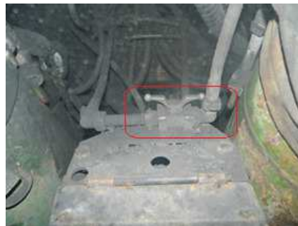
Rys. 7. Zawór odcinający, sterujący przepływem wody i sprężonego powietrza [10]
