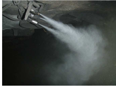
Rys. 5. Bateria zraszająca powietrzno-wodnego systemu zraszania typu KOMAG-N zamontowana pod stropnicą sekcji obudowy zmechanizowanej [10]
