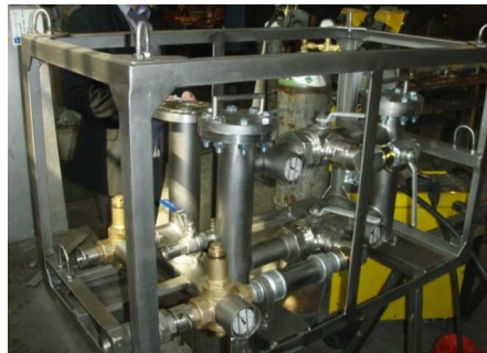
Rys. 6. Zespół zasilający powietrzno-wodnego systemu zraszania [10]
