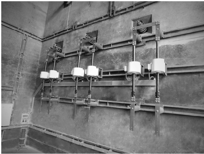
Fot. 1. Układ przekładników zamontowanych w obwodzie zwiarciovym IEL ( komora VI )
