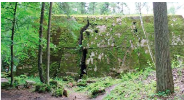
Rys. 5. Widoczna pęknięta, lecz zachowana w całości ściana bunkra ciężkiego (fotografia własna)
