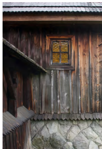
Ryc. 8. Przesuszenia i spękania na elewacji południowej, fot. M. Petri
