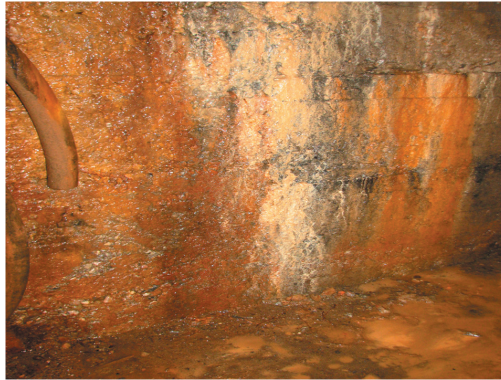
Ryc. 2. Nacieki żelaziste na obudowie betonowej (fot. W. Preidl)
