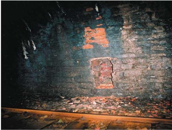
Ryc. 7. Przykład zespolonego oddziaływania fizycznych, chemicznych i antropogenicznych czynników destrukcyjnych w wyrobisku podziemnym (fot. W. Preidl)
