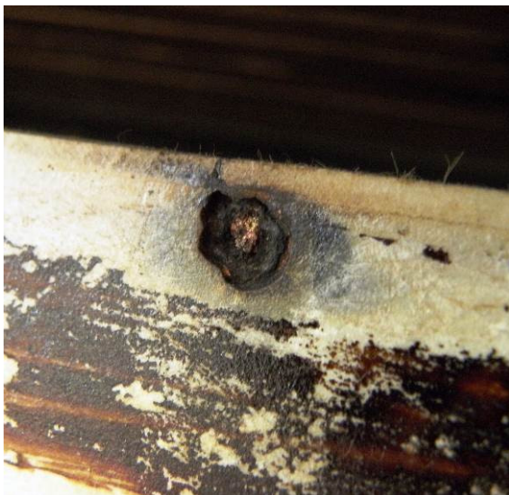
Rys. 4. Przykładowe uszkodzenie izolacji [2]
