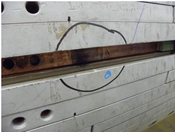
Rys. 3. Zdjęcie przedstawia uszkodzenie izolacji w części żłobkowej [2]
