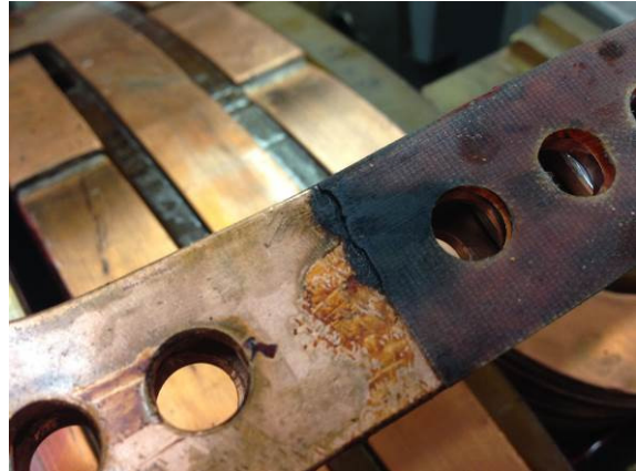
Rys. 6. Przykładowe uszkodzenie izolacji [2]
