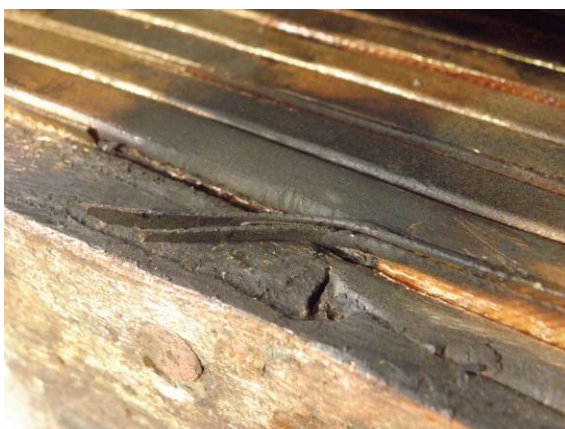
Rys. 5. Przykładowe uszkodzenie izolacji [2]
