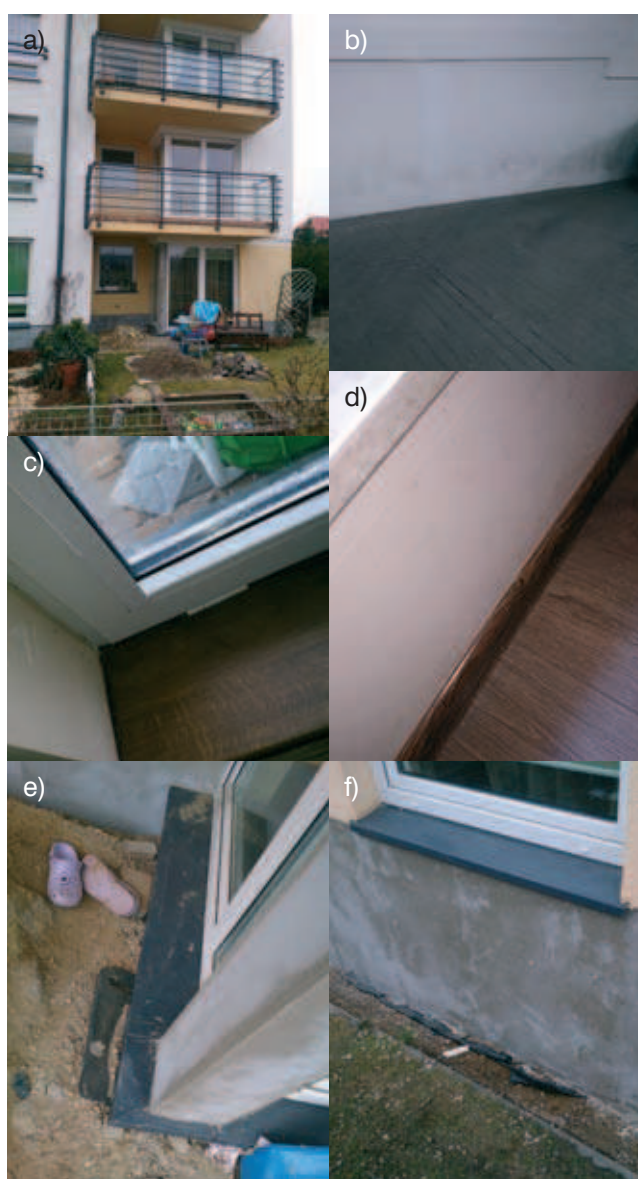
Rys. 1. Wielorodzinny budynek mieszkalny: a) widok elewacji, korozja biologiczna, b) ścian podziemnej hali garażowej, c) ościeża oraz d) strefy podparapetowej w lokalu mieszkalnym w poziomie parteru, dodatkowe ocieplenie, e) narożnika systemowego z PCV oraz f) cokołu w strefie przyziemia
