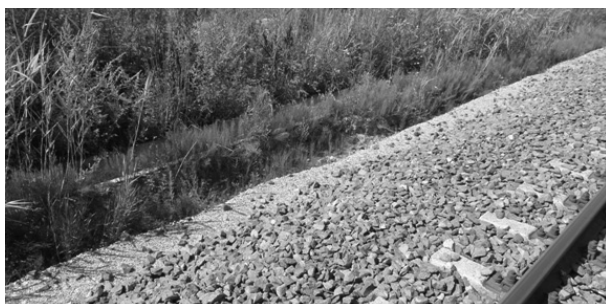
Rys. 8. Widok toru po zakończeniu robót z użyciem maszyny AHM 800R; nieścięta ława torowiska, zarośnięte rowy [fot. G. Pływaczyk]
