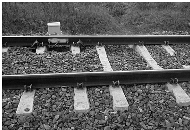
Rys. 7. Niewłaściwy rozstaw podkładów i niepełne osłonięcie ich czół [fot. L. Szramka]
