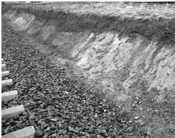
Rys. 4. Brak odpowiedniej szerokości ławy torowiska, brak rowu odwadniającego, nieodpowiednie nachylenie skarpy przekopu [fot. T. Kaźmierczak]
