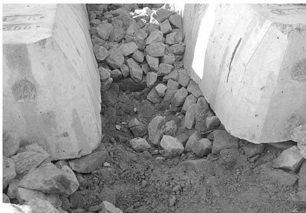
Rys. 5. Uszkodzenie warstwy ochronnej w czasie podbijania podkładów przy braku odpowiedniej grubości warstwy podsypki [fot. M. Karczewski]
