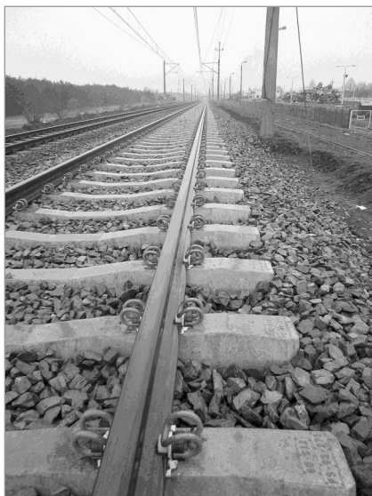
Rys. 6. Niewystarczająca ilość podsypki w okienkach i od czół podkładów (0,25 m zamiast 0,45 m), brak odwodnienia od strony prawego toru [fot. T. Kaźmierczak]
