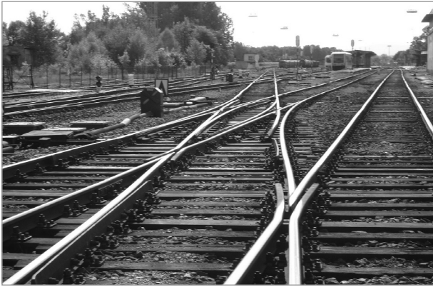
Rys. 10. Na wstawce za krzyżownicą rozjazdu widocznego na rysunku 9 powstał łuk o promieniu około 900 m [fot. S. Bucyk]
