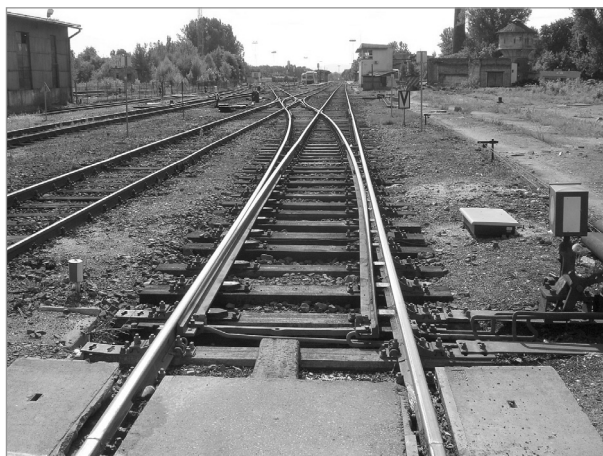
Rys. 9. Rozjazd 300-1:9 mający styk przediglicowy na drodze kołowej [fot. S. Bucyk]
