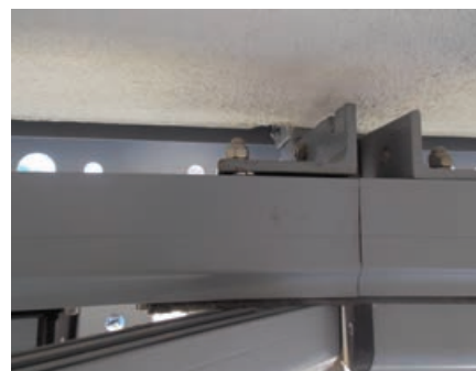
Rys. 8. Brak przekładki EPDM, pod śrubą zastosowano zwykłą przekładkę
