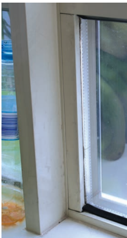
Rys. 4. Brak pionowej uszczelki, źle dobrane długości uszczelki poziomych
