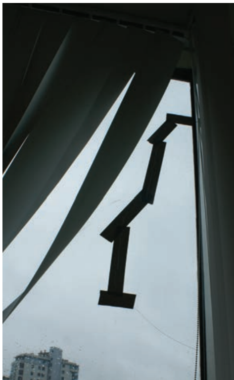
Rys. 2. Pęknięta wewnętrzna tafła, inicjacja pęknięcia w połączeniu ze słupem aluminiowym
