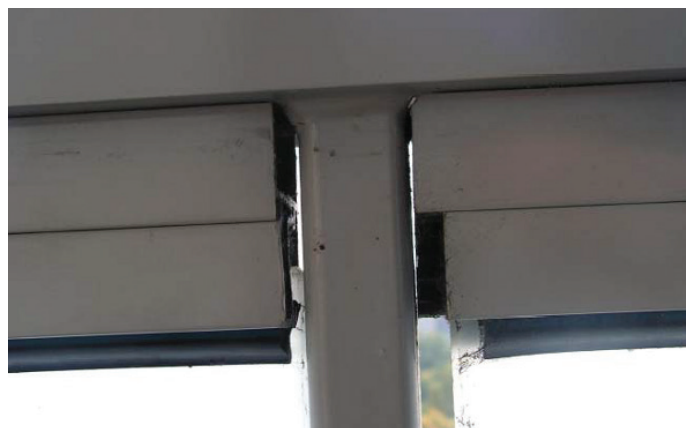
Rys. 6. Niewłaściwe zamocowanie szyby, która bezpośrednio uderza w metalowy element podczas przesuwania rozwieranych paneli
