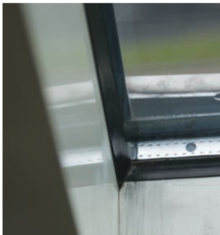
Rys. 3. Nieprzylegające, źle spasowane uszczelki w narożniku okiennym, widoczne osady powstałe przez przenikanie wody do wnętrza budynku
