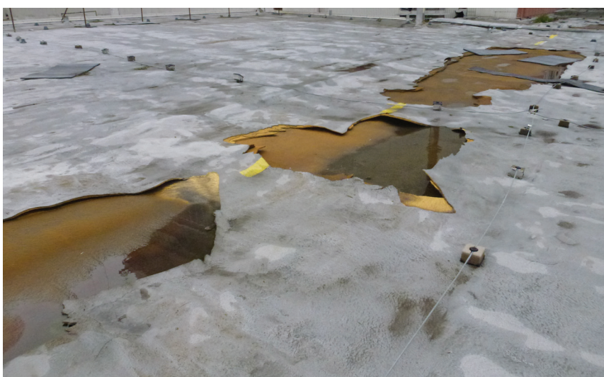
Fot. 7. Rozwarstwienie i uszkodzenia pianki PUR w pokryciu dachu budynku maszynowni
