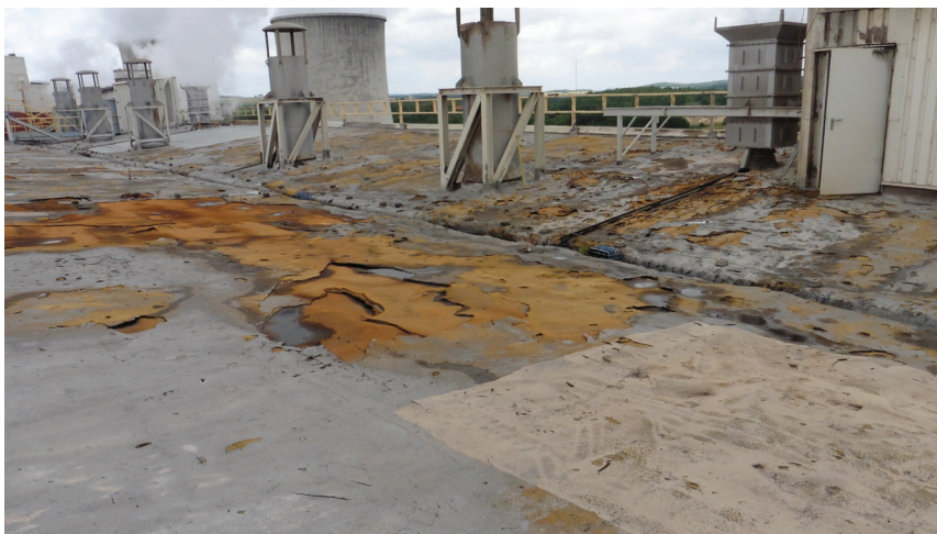
Fot. 5. Zniszczone pokrycie z pianki PUR przy wyrzutniach pary w budynku kotłowni
