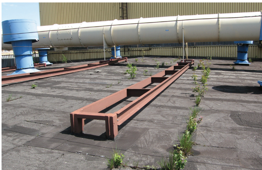
Fot. 4. Mocno zniszczone pokrycie papowe na wełnie mineralnej w budynku zasobnika węglowego
