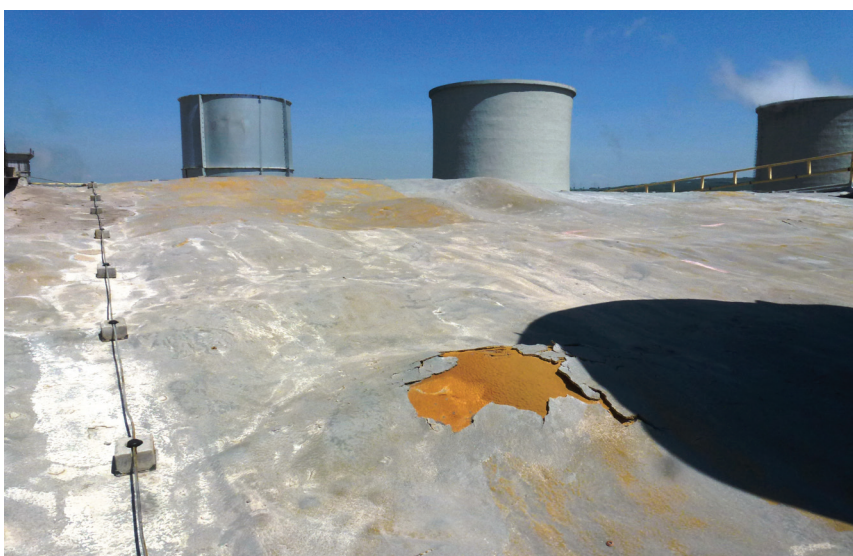
Fot. 6. Znaczne wyrzuszenia i pęcherze pianki PUR w pokryciu dachu budynku kotłowni
