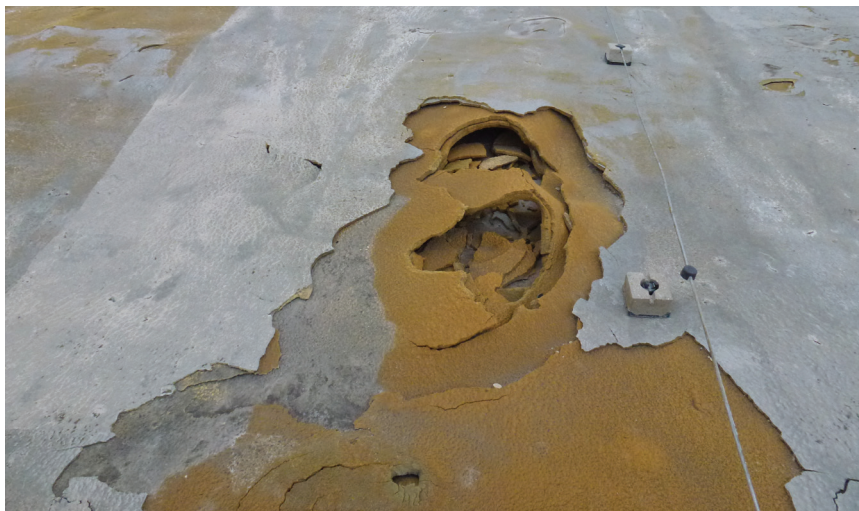
Fot. 8. Lokalne uszkodzenia pianki PUR w pokryciu dachu budynku maszynowni
