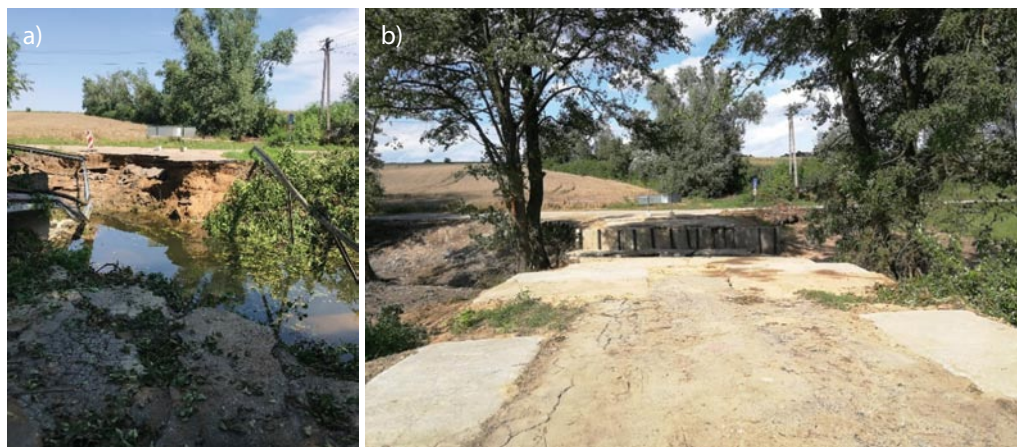
Rys. 6. Warunki terenowe w miejscowości Szeligi: a) stan popowodziowy, b) stan po zabezpieczeniu podmytych przyczółków i wstępnym przygotowaniu krótkich placów montażowych
