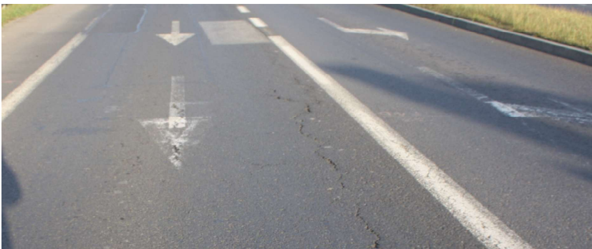
Rys. 6. Pojedyncze spękania podłużne o dużym stopniu szkodliwości w km 189+000
