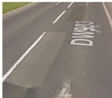
Rys. 4. Zainicjowane spękania oraz wykonane już naprawy w czerwcu 2012, w km 189+000 (www.google.pl)
