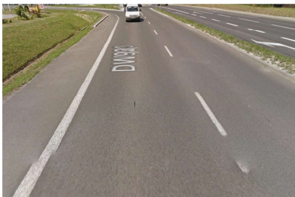
Rys. 3. Brak spękań na nawierzchni w czerwcu 2012 w km 188+800 (www.google.pl)
