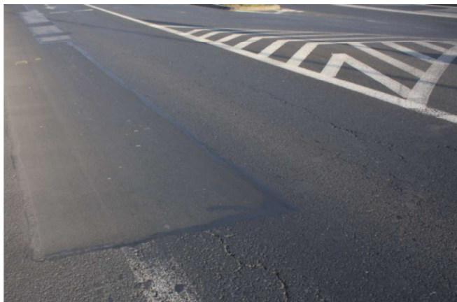
Rys. 5. Pojedyncze spękania podłużne o dużym stopniu szkodliwości - km 189+060, rok 2018
