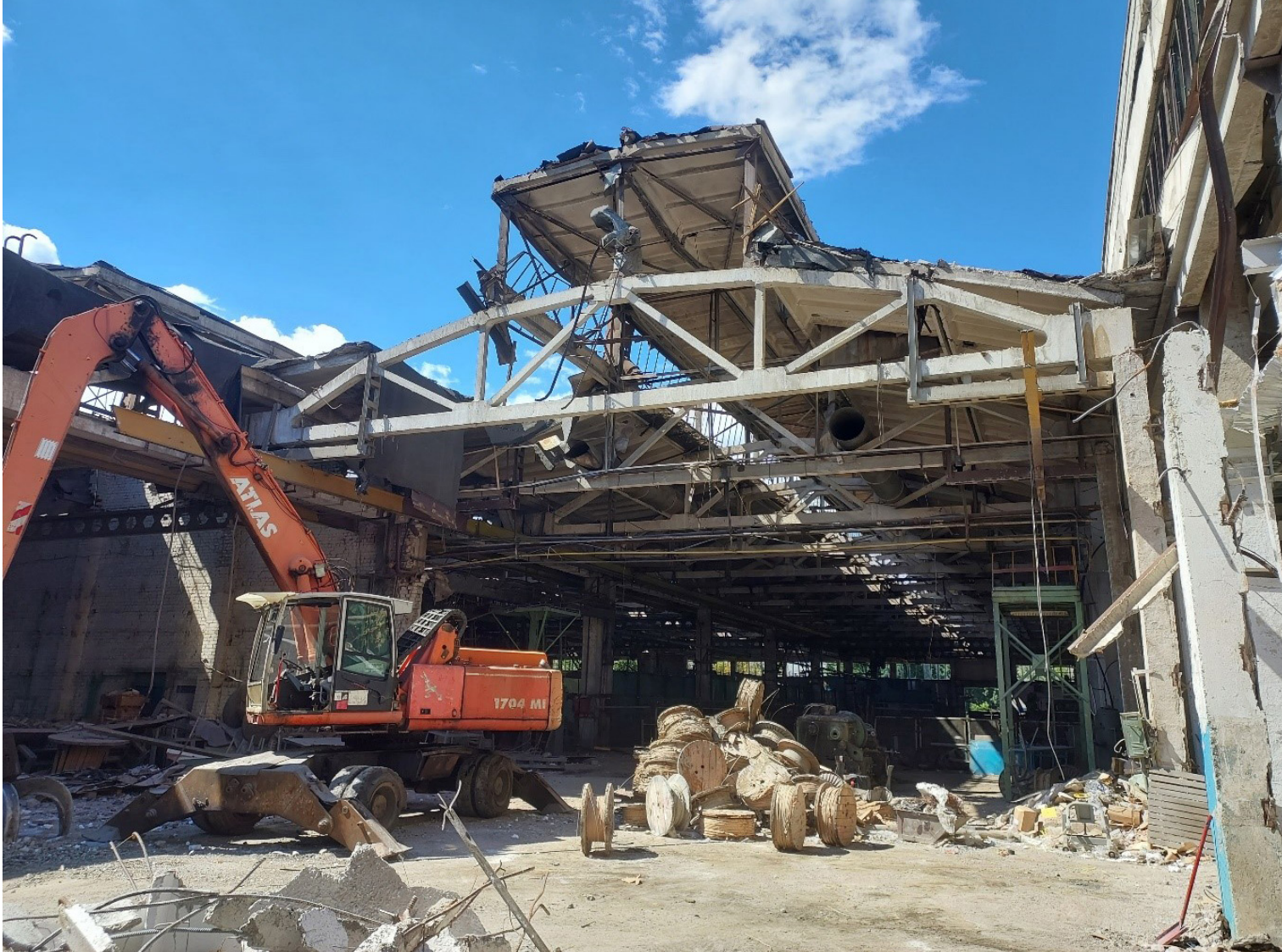
Il. 4. Przemysłowy prefabrykowany budynek szkieletowy zniszczony w Zaporozżu, 22.07.2022, fot. Nastroy LLC Il. 4. Industrial concrete pre-cast frame building destroyed in Zaporizhzhia, 22.07.2022, photo: Nastroy LLC
