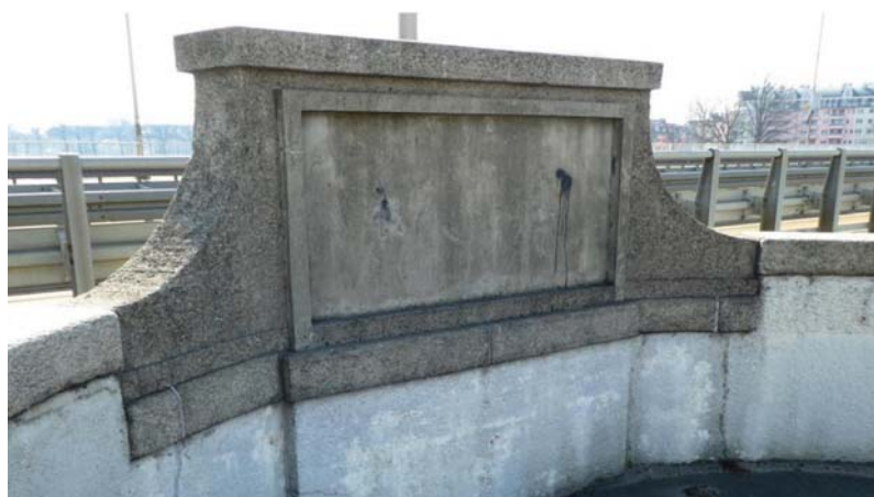
Fot. 18. Miejsce po tablicy pamiątkowej nieznannej treści na filarze VI pomiędzy częścią łukową i sklepioną mostu
