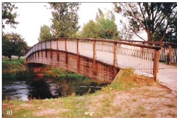
Fot. 1. Kładki w Brodnicy: a) zbudowana w latach 80-tych XX w., b) zbudowana w 2015 r. [8]
