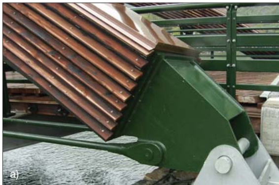
Fot. 7. Przykłady zabezpieczenia dźwi-garów drewnianych przed działaniem czynników atmosferycznych: a) szalówką i blachą miedzianą (most w m. Flâm, fot. D. Rewers), b) blachą nierdzewną (kładka w Brodnicy, fot. C. Oracz)
