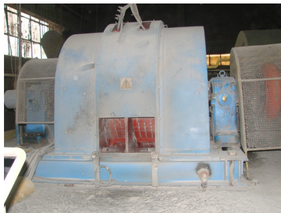
Rys. 1. Napęd młyna w jednej z cementowni, tj. silnik indukcyjny 3-fazowy, pierścieniowy typu DOLMEL SYUe-148r/01, o mocy P_N = 1000kW , n = 738 obr/min
