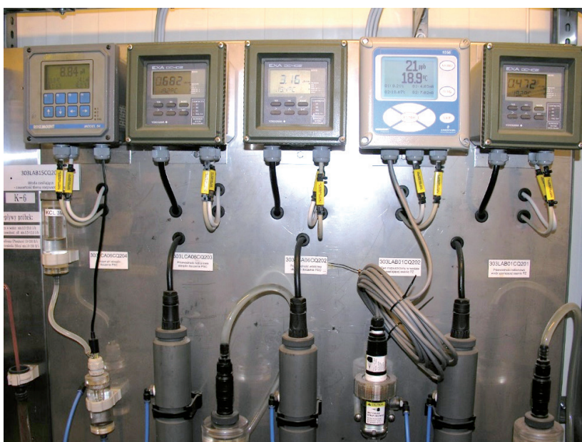
Fot. 4. Aparatura pomiarowa wody zasilającej i skroplin z głowicami pomiarowymi (źródło: ENERGOPOMIAR)
