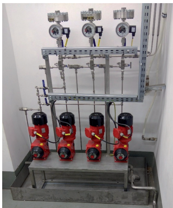
Fot. 1. Stacja dozowania fosforanów dla kotłów K-1, K-2, K-3 (źródło: ENERGOPOMIAR)
