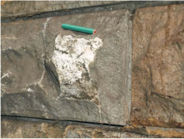
Ryc. 3. Wykwit podpowierzchniowy soli krystalizujących na piaskowcowej okładzinie wyjścia zachodniego pod szklanym sufitem przejścia południowego. Sytuacja z chwili po zdjęciu przykrywającego wykwity powierzchniowego płata piaskowca. Stan z początku maja 2010 r. Długość ołówka – 6 cm
