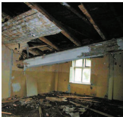
Widok zniszczonej sali operacyjnej, listopad 2005. Fot. P. Gerber
